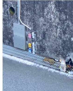
冠水センサー設置例
